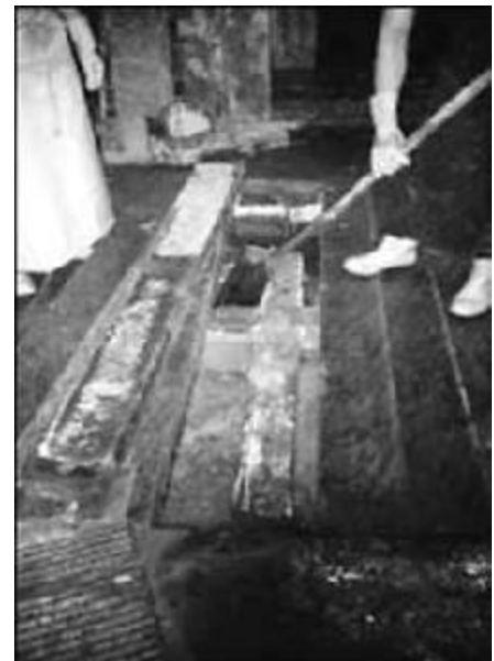
Fotografía 3. Vista de una trampa de grasas.
