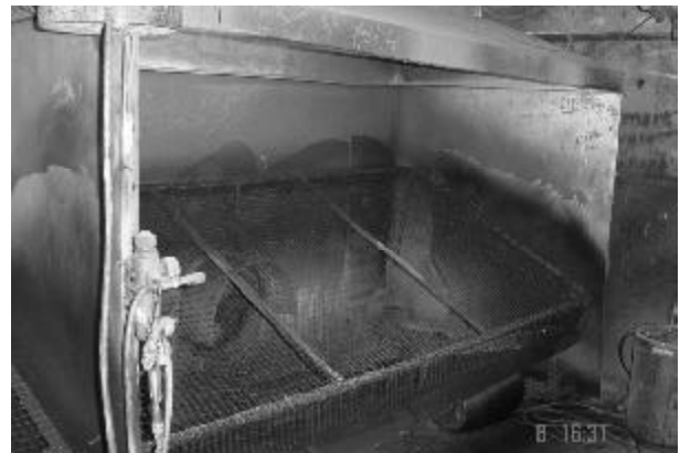
Fotografía 1. Cámara de pintura típica de una mipyme.
